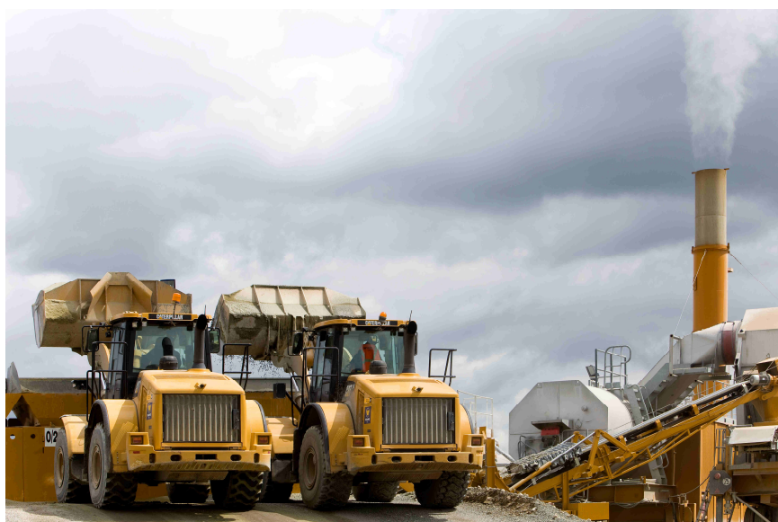
Chargement des trémies de la centrale RF 400
